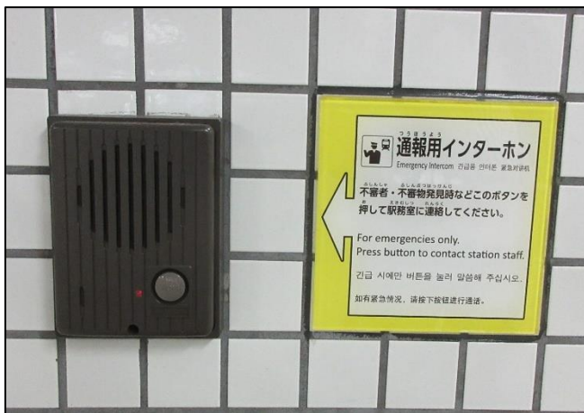
駅構内通報装置
