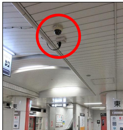
駅構内防犯カメラ
