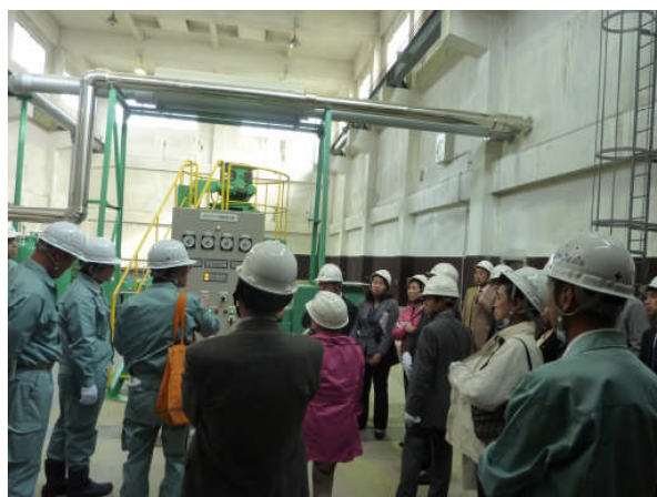
小栗栖排水機場
