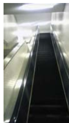
建物内エスカレーター
