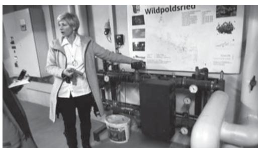
地域暖房施設
