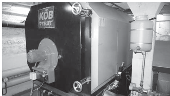
ペレットボイラー
